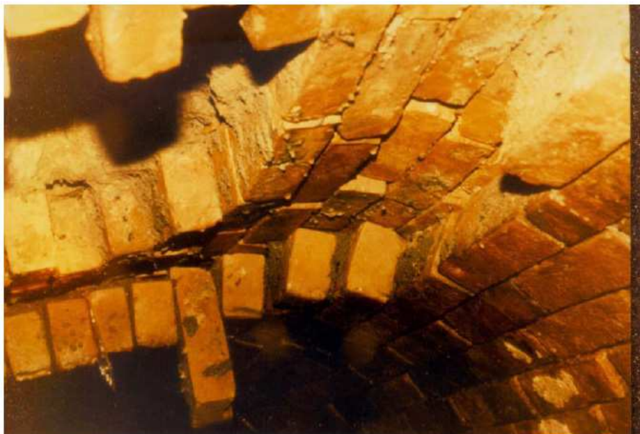
Abbildung 3.7: Fehlende Teile in einem gemauerten Kanal
